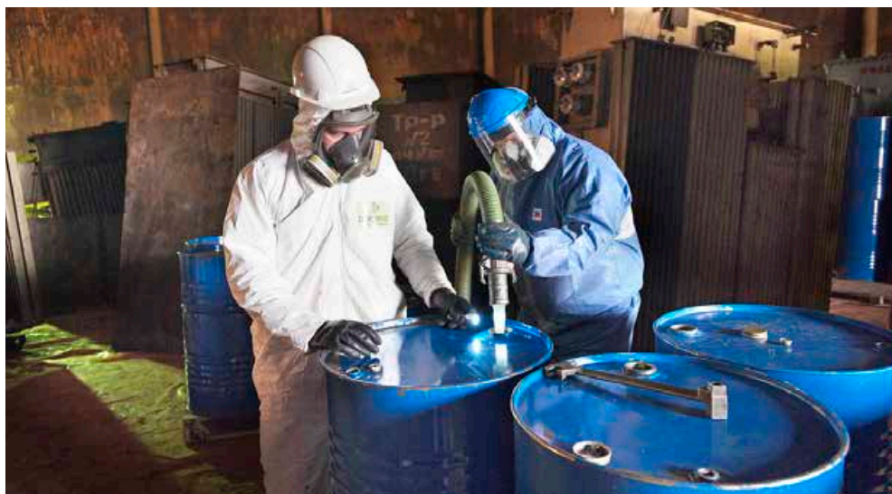
DRAINAGE D'HUILES DE TRANSFORMATEURS CONTAMINÉES AUX PCB À ARCELORMITTAL TEMIRTAU (KAZAKHSTAN). PHOTO DE POLYECO.
