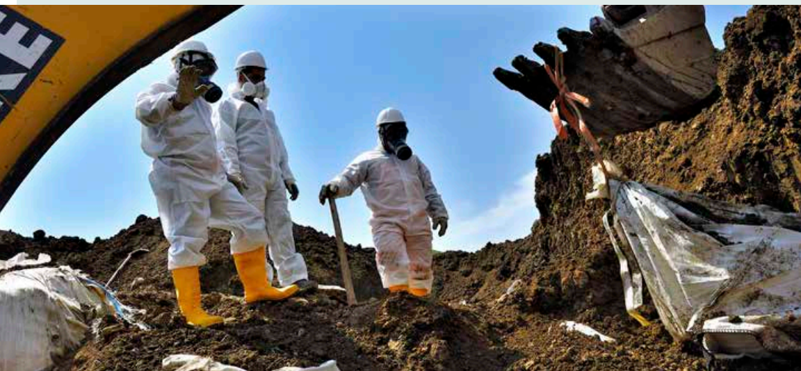
EXCAVATION DES PESTICIDES POP AU SITE D'ENFOUSSEMENT DES PESTICIDES À LAGLUJA, EN GÉORGIE. PHOTO DE VLADIMIR VALISHVILI.
