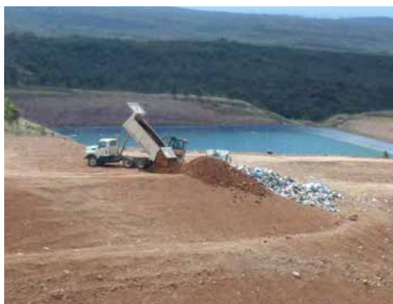
LA DÉCHARGE RÉCEMMENT OUVERTE DE COMAYAGUA (HONDURAS). PHOTO DE LUIS ORTEGA.
