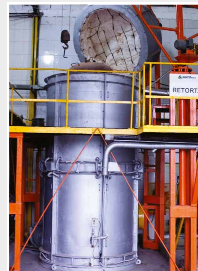
Installation Apliquim Brasil Recicle, spécialisée dans le traitement des lampes fluorescentes © Apliquim Brasil Recicle
