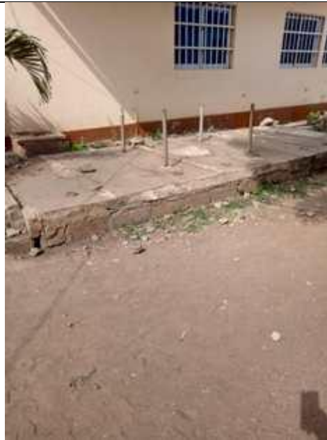
Photo 14 : Fosse septique à 3 compartiments qui recueille les eaux usées de laboratoire au CHP Notsè
