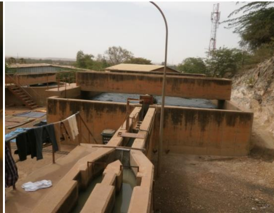
Station d'épuration des eaux usées à l'hôpital national
