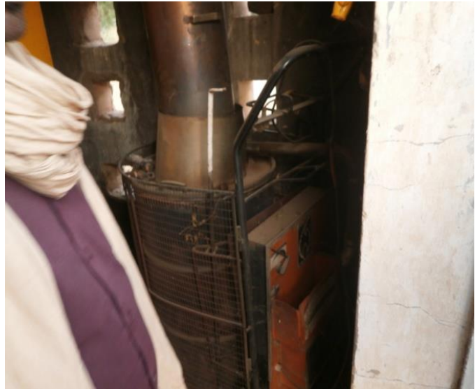
Incinérateur du service vétérinaire non fonctionnel
